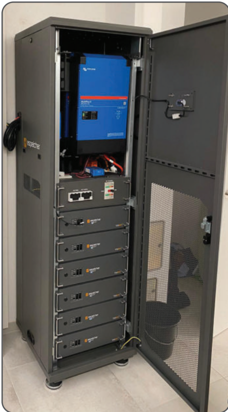
Projekt: Privathaushalt 15kVA 30kWh
