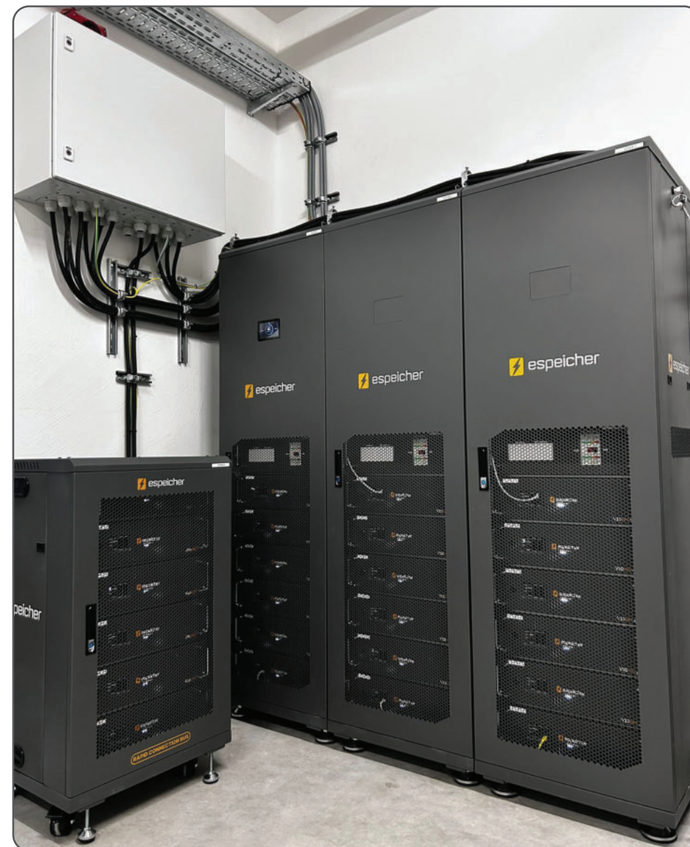
Projekt: Logistikzentrum 45kVA 120kWh
