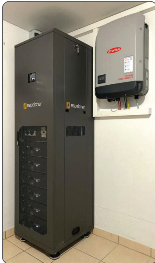
Projekt: Privathaushalt 15kVA 30kWh
